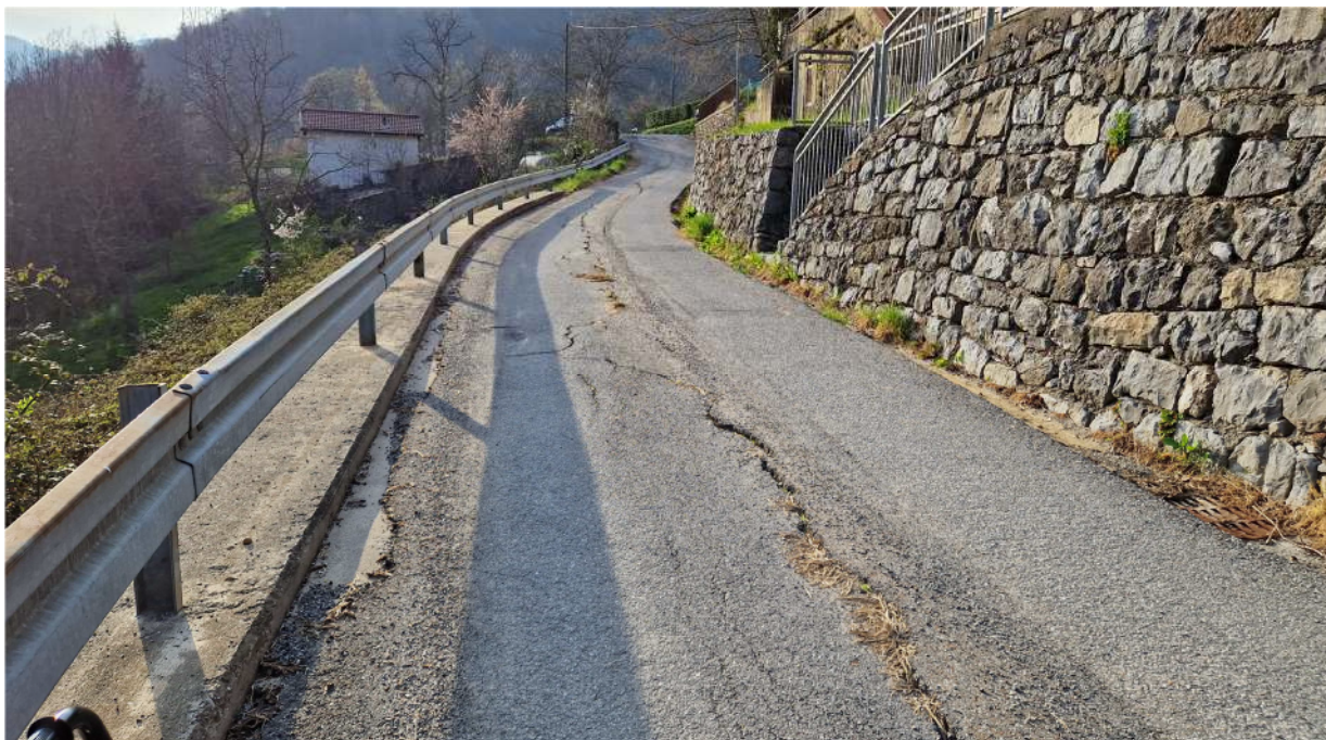
Cedimento e fessurazione della pavimentazione
